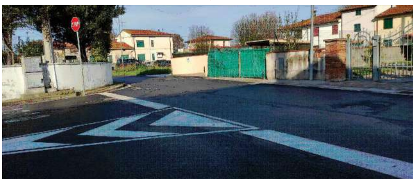
VISTA VISIBILITA' IN SINISTRA DA CORSA DI DESTRA (VISIBILITA' INSUFFICIENTE PER V= 50 KM/H SECONDO IL DM 19-4-2006)
