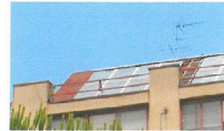
10 - Vista de coperto con i pannelli solari
