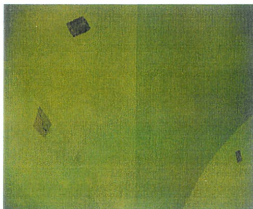
S3 Porticato coperto. Differenti strati di tinteggiature
