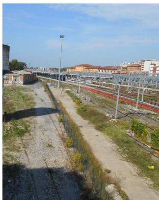
Figura: cavi elettrici binari Cavalcavia di San Giusto
