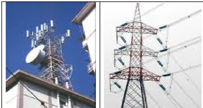
Foto stazione radio - elettrodotto
