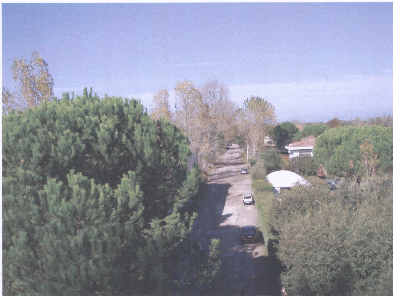
Foto 2 - Via delle Giunchiglie - La strada ad oggi si presenta molto dissestata, risulta priva di un piano stradale definito; inoltre, a causa del passaggio di mezzi, anche pesanti, che la utilizzano per raggiungere il magazzino edile e la carrozzeria, posti lungo questa strada, essa è piena di buche e dossi.
