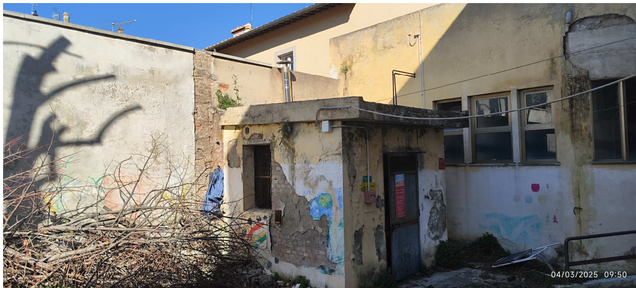
Centrale termica realizzata nel 1979 – Delibera G.C. n.3801 del 07/09/1979
