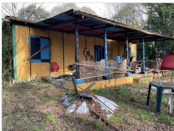
Figura 1 Edificio legno misto muratura non agibile (da demolire)
