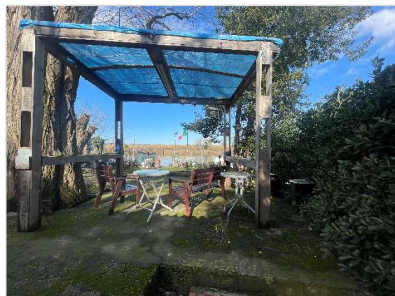
Figura 6 Tettoia in legno da demolire
