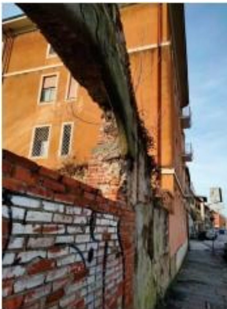
Foto 14 Foto di ciò che rimane della facciata al piano terra sul Lungarno Galilei
